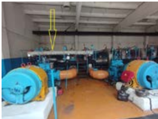
Рисунок 4 – Внедрение узла рециркуляции насосов №1 и №2 на насосной станции №1 ТМ-20-32 Южного сетевого района
