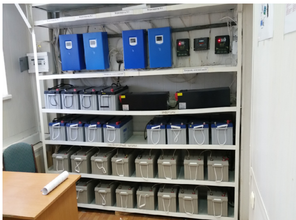
Рисунок 8 – Общий вид установки оборудования ветросолнечной электростанции
