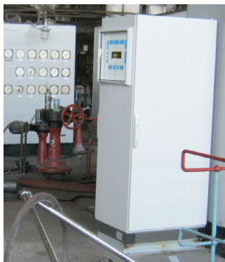
Рисунок 2 – Шкаф управления ЭГСР
