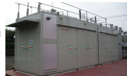
Рисунок 4 – Общий вид Battery Power System
