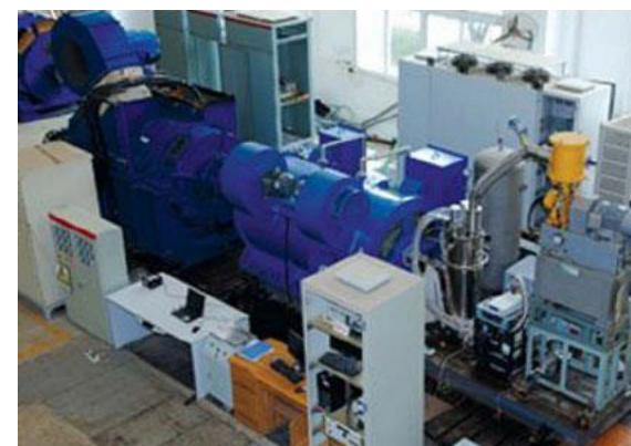
Рисунок 5 – Прототип ВТСП электродвигателя мощностью 1 МВт
