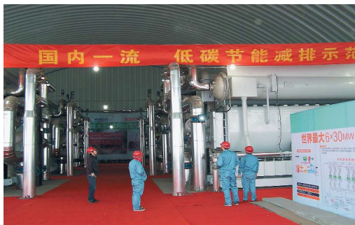
Рисунок 3 – Теплонасосное оборудование ТЭЦ г. Янгжин
