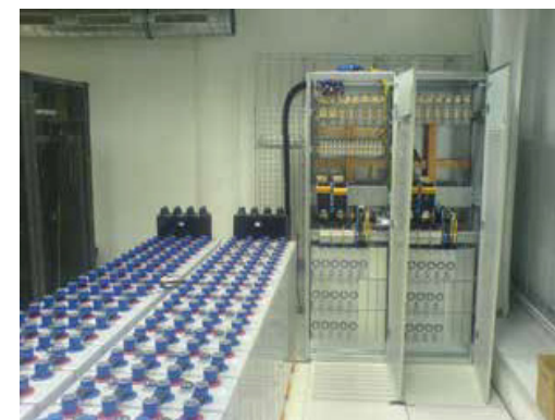
Рисунок 5 – Внешний вид инвертора и аккумуляторной батареи большой емкости в лаборатории
