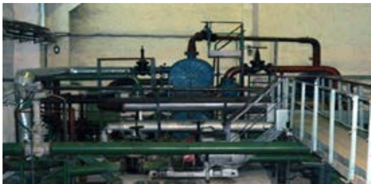
Рисунок 1 – Первый в Республике Казахстан тепловой насос НТ-3000 (тепловая мощность 3,7 Гкал) на АО «Казцинк» (г.Усть-Каменогорск, декабрь 1999 г.)
