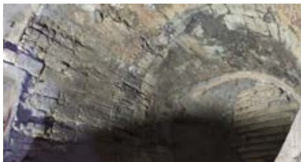
Рисунок 3 – Состояние внутренней поверхности футеровки ковша перед выводом в ремонт
