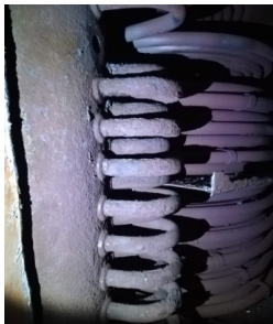
Рисунок 1 – Общий вид системы змеевиков ПВД после вскрытия
