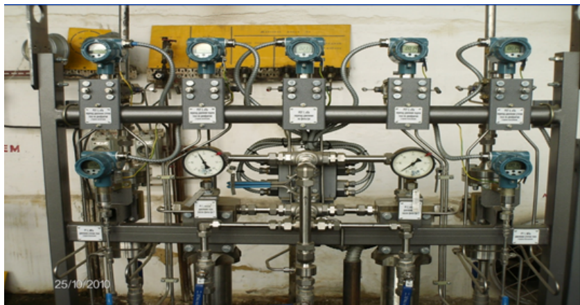
Рисунок 8 – Общий вид стойки управления СГДУ
