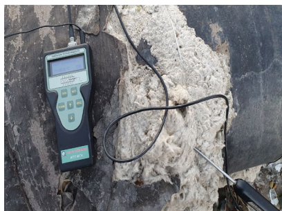
Рисунок 2 – Участок теплоизоляции без защитного слоя
