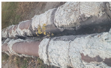
Рисунок 1 – Общий вид теплоизоляции трубопровода
